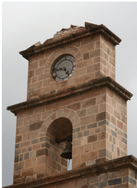
Cumbre y cruz de la torre de San Blas, Cusco, destruida por un rayo (noviembre de 2006).
